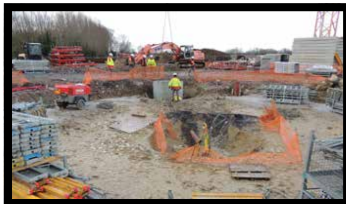
Ouvrier de chantier (station d'épuration de Richebourg)
