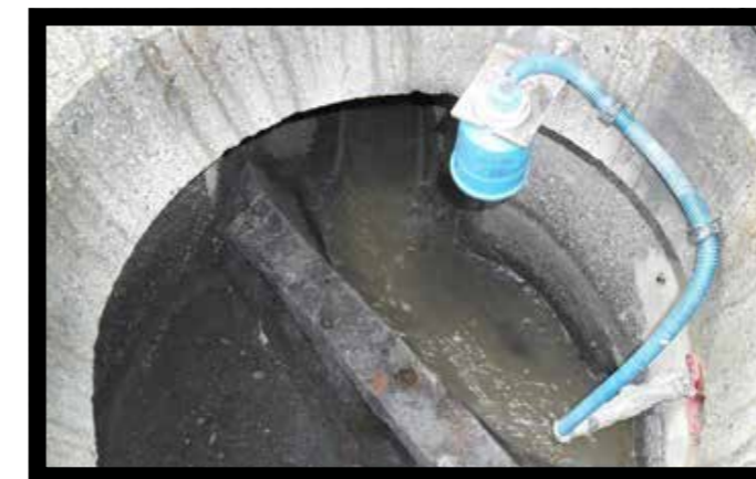
Déversoir d'orage au niveau d'un réseau d'assainissement équipé d'un matériel d'autosurveillance (sonde ultrason)
