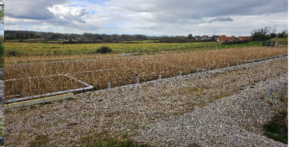
Station d'épuration d'Hardinghen (950 eh)
