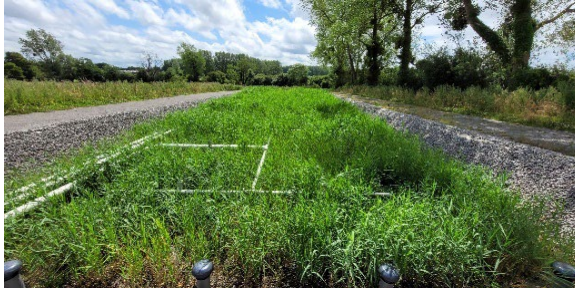
Station d'épuration de Le Wast (300 eh)
