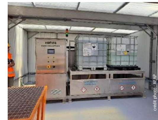
Traitement tertiaire de désinfection à Quend-Fort-Mahon
