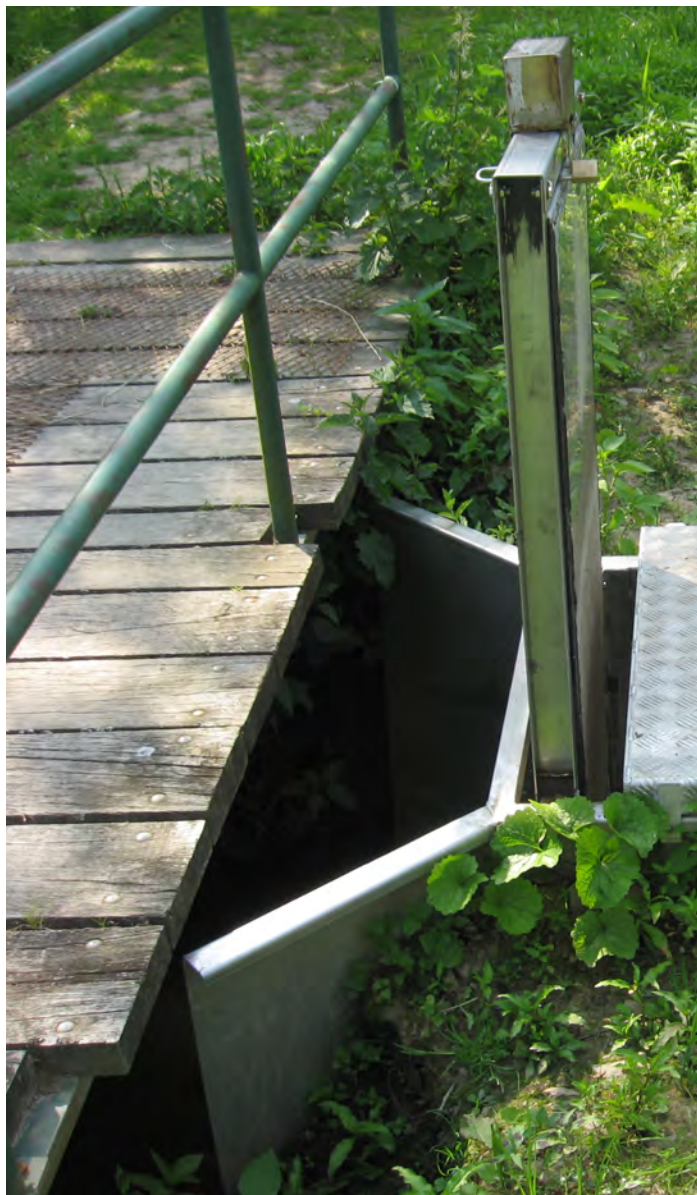
Vanne en aval
